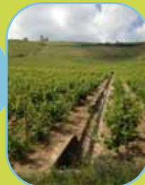
Fossé revêtu : demi-buses de béton
